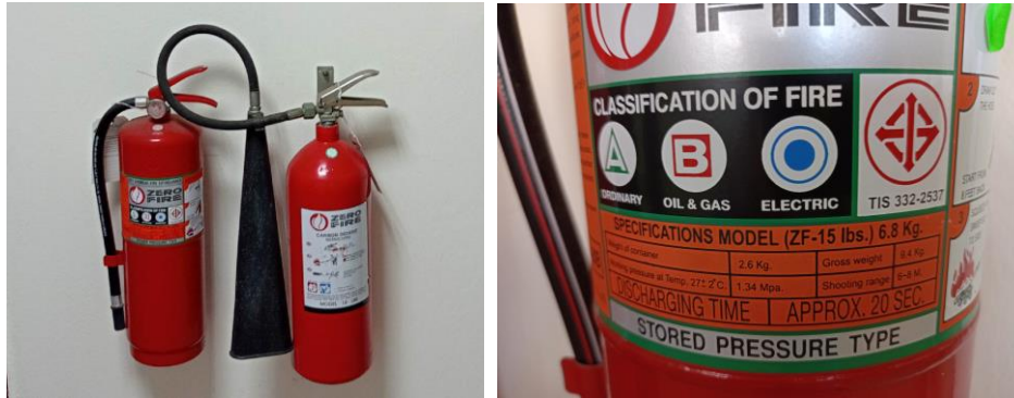
ภาพที่ 2 ถังดับเพลิง
